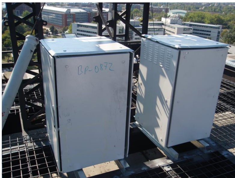
15. ábra A RF rack szekrények az antennarendszer talppontjában
