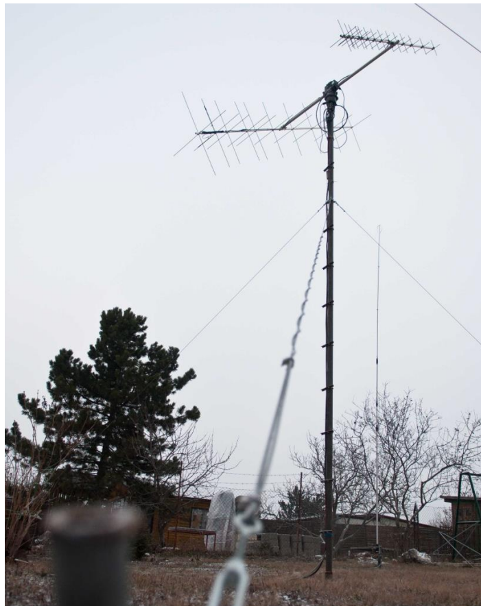
20. ábra A másodlagos földi vezérlő állomás antennája
