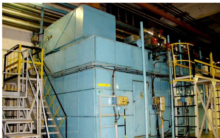
3. ábra Rekonstrukció előtti klímagép
