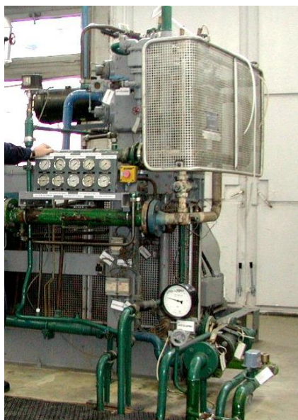
2. ábra Rekonstrukció előtti kompresszor
