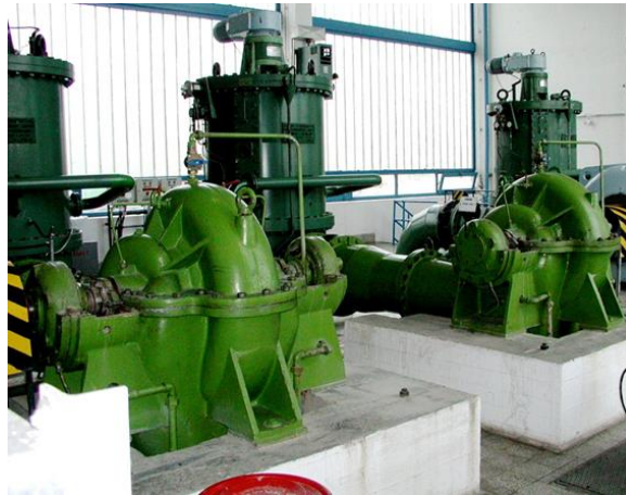
5. ábra Ipari hűtővíz szivattyútelep
