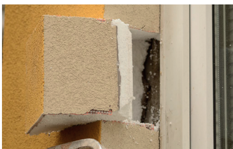
8. ábra. Hőszigetelő rendszer gyakori kivitelezési hibája. A nyílászáró mentén megszakad az üvegszövet-erősítés és a tapasztolás
