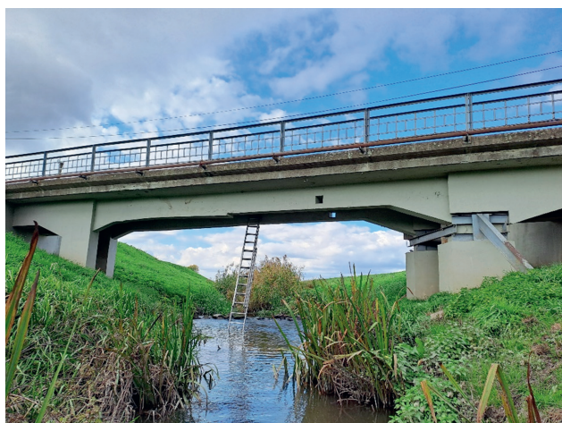
7. kép: A borsodivánkai Eger-patak-híd vasbeton főtartója robbantó fészekkel
