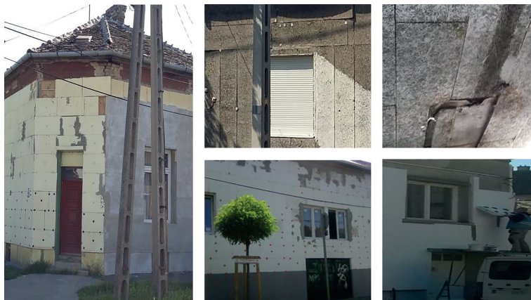
10. ábra. Képek az épületek szigetelés-korszerűsítési munkálatainak hibáiról
