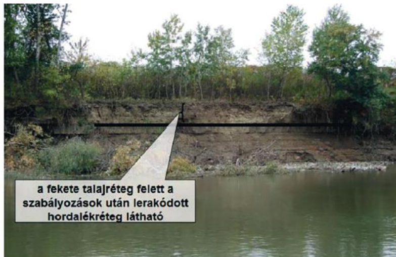
2. ábra. Árapasztó csatorna állapota Szolnoknál
