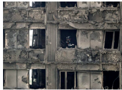
3. ábra. Hiányzó és kimozdult nyílászárók a Grenfell Tower tüzesetét követően
