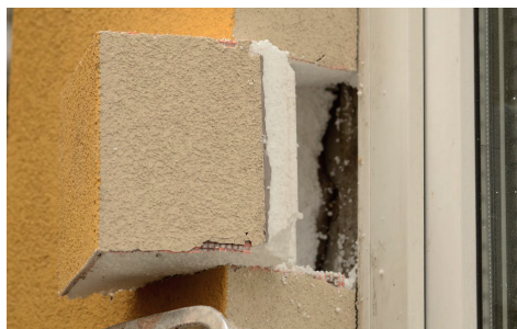
8. ábra. Hőszigetelő rendszer gyakori kivitelezési hibája. A nyílászáró mentén megszakad az üvegszövet-erősítés és a tapasztolás
