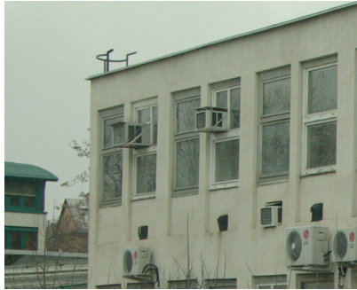
7. ábra. Nyílászáróba épített és falra szerelt klímaberendezések
