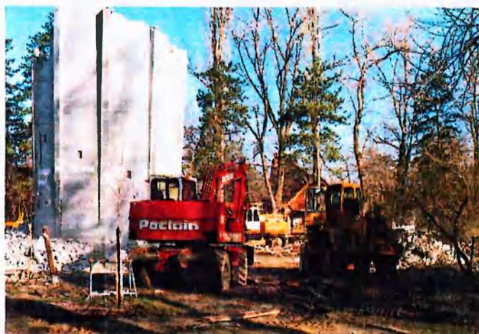
Siófok-Balatonszéplak ezüsprati 45 m magas víztorony bontása harapógéppel. Montabert típusú harapógéppel bontható szerkezet vastagsága 60-70 cm.
