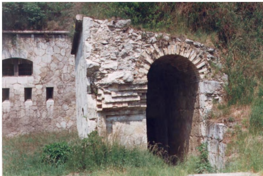
A lebontott külső kapu maradványa a föltárt falszerkezettel
