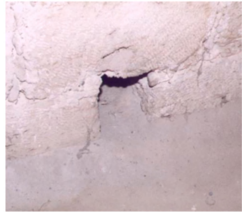
Alsó levegő bevezető nyílás ugyanott
