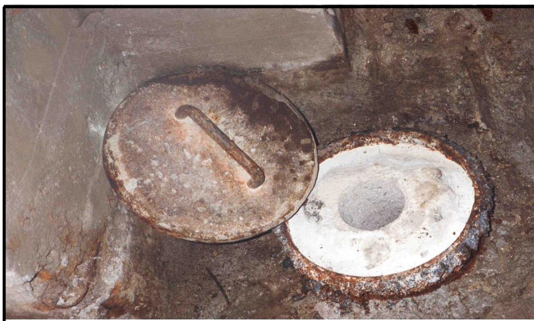
10. sz. ábra A robbantókamra felnyitása után a fémcső és az azt lezáró aknatető elhelyezkedése a betonban
