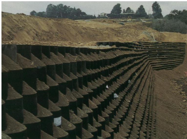
18. ábra: Geocellából készült támfal
