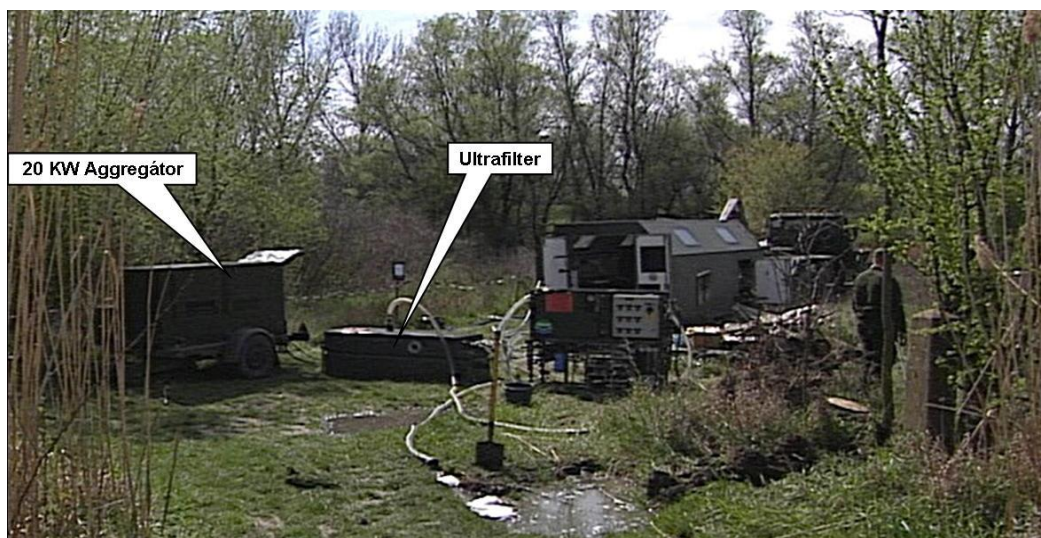
Telepített ZENON–2,5 zászlóalj típusú víztisztító berendezés
