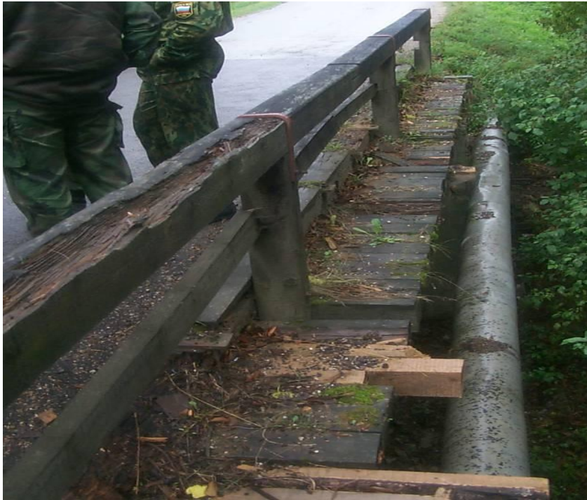
2. sz. kép Kártevők és gombák okozta károk a hídszerkezetben. 3
