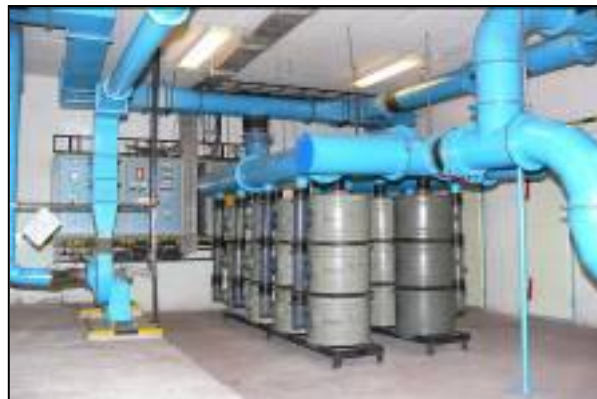
6. sz. kép: A WC-csoport szellőzőrendszere a bűzszűrőkkel 8
