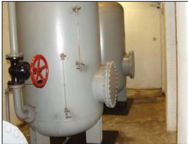
8. sz. kép: A nyomásfokozó berendezés gépháza 10
