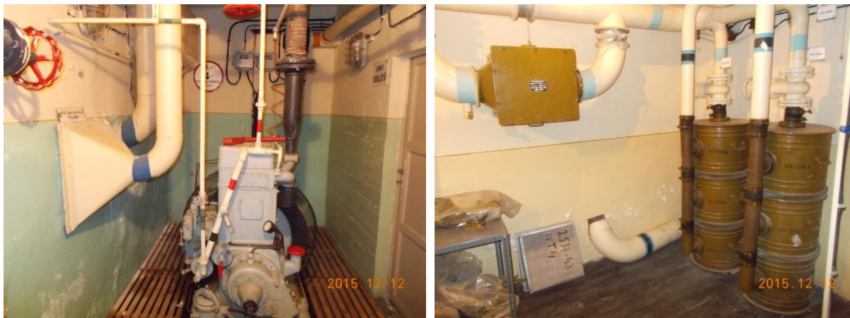
13-14. kép: A 13. (baloldali) képen 1960-as években épített kerületi vezetési pont dízel gépháza, a 14. (jobboldali) képen a létesítmény por- és gázsűrői láthatók. 19
