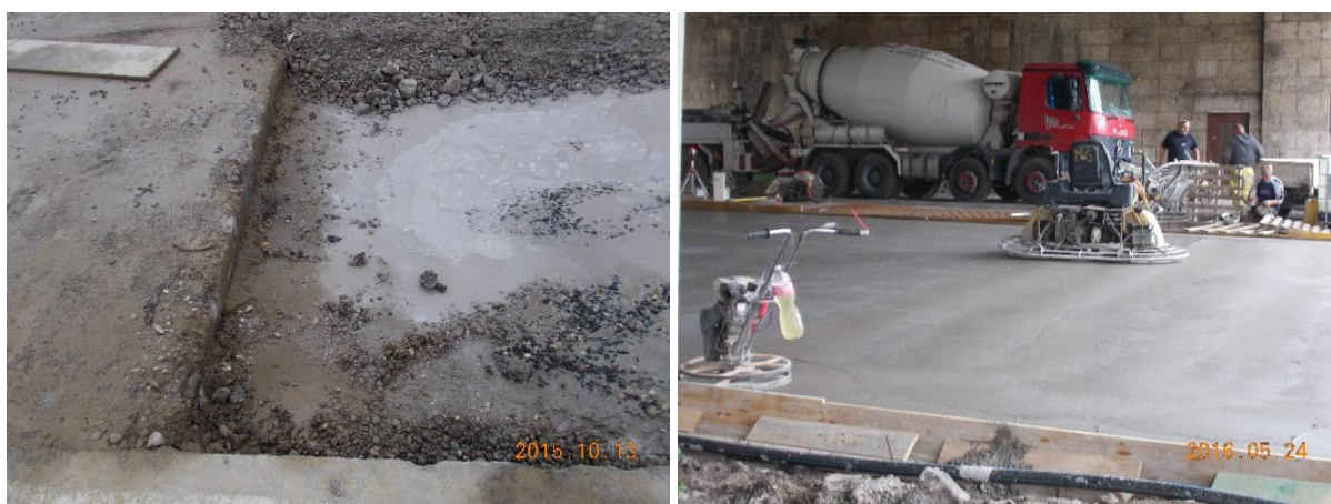
3-4. kép: A 3. (baloldali) képen felújítandó beton pályaszerkezet hiányzó, dilatált részlete, a 4. (jobboldali) képen kültéri betonszerkezet kivitelezése 8
