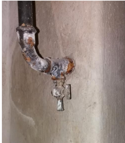
37. ábra: Korrodált gáz mintavételezési csap a volt I. kerületi PV vezetési pontban (budai Vár) 41
