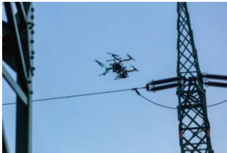
8. kép: Elektromos hálózat hibafelderítése termokamerával felszerelt UAV-val 17
