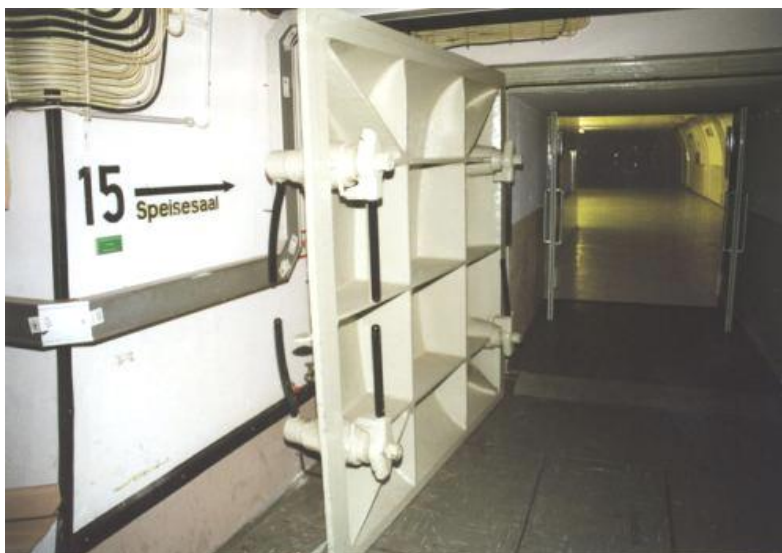
18. ábra: Marienthali kormányóvóhely a volt NSZK-ban kézi forgó zárócsappal 25
