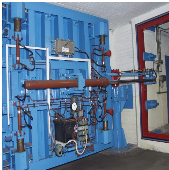
30. ábra: Budapesti metróban hidraulikus működtetésű kapu (reteszelővel) 36
