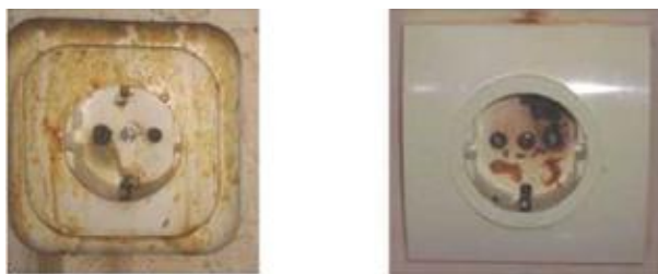
2.ábra: Túlterhelt, megégett fali csatlakozó aljzatok 3
