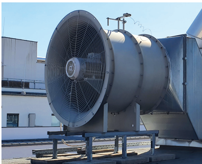
2. ábra: A lépcsőház füstmentesítő ventilátora a zárófödemen
