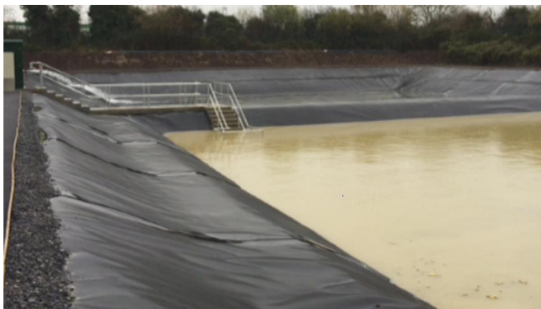
4. fénykép: Oltóvíz felfogó tároló létesítmény [11]
