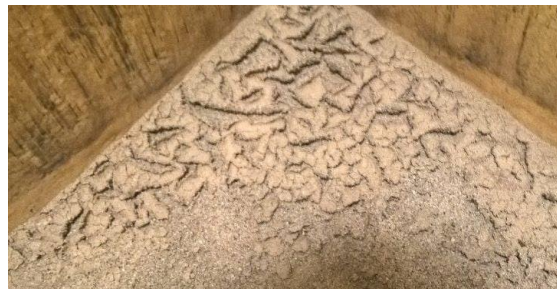
5. ábra Homokszűrő felületén kialakult kolmatálódott biofilm a szűrő víztelenítését követően [6]
