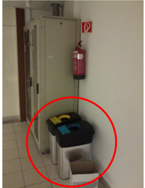
4. kép Csak nyújtott karokkal elérhető tűzoltó készülék (saját felvétel)
