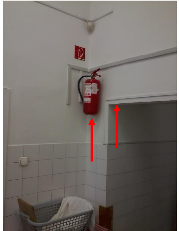
2. kép Falnyílás mellett 2 m magasságban elhelyezett tűzoltó készülék, alatta megközelítést korlátozó tárolás (saját felvétel)
