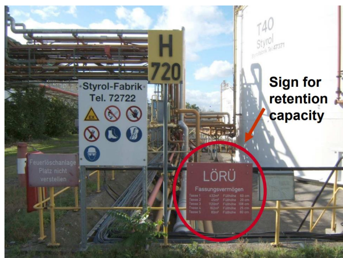
2. fénykép: oltóvíz felfogó tároló létesítmény [10]
